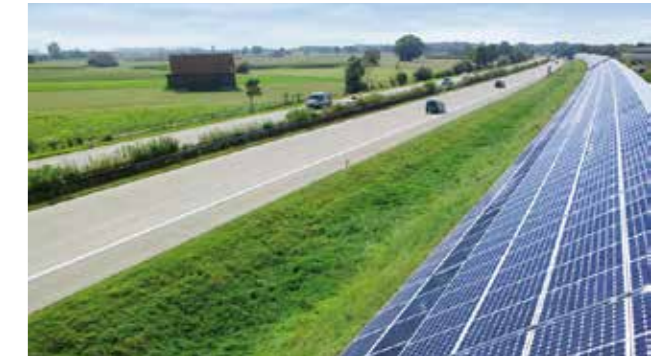
Zonnepanelen in combinatie met geluidsscherm
