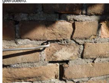
Foto 24 De hechting van het voegwerk is regelmatig envoldoende.
