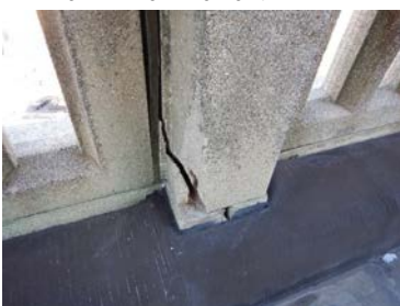
Foto 17 Plaatselijk zijn de betonnen balusters gescheurd door roestende stalen wapening/doken.
