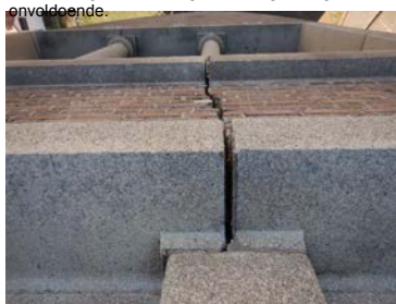
Foto 18 Bij de roestende stalen wapening/doken voor de betonnen balusters zijn in de gevels verticale scheuren aanwezig.
