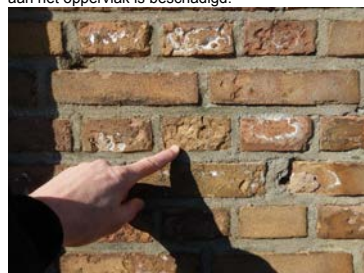
Foto 22 Regelmatig zijn de bakstenen aan het oppervlak geërodeerd.
