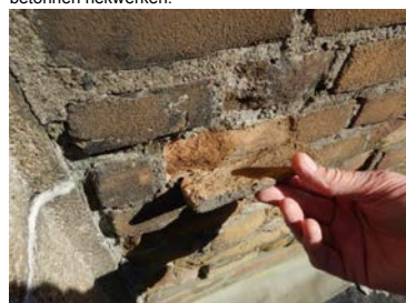
Foto 21 Plaatselijk schilferen bakstenen af.
