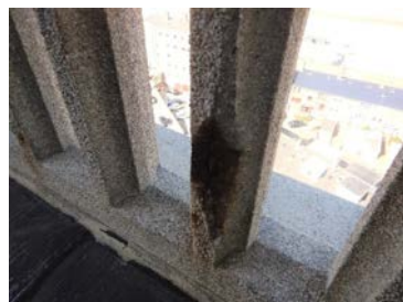
Foto 19 Plaatselijk is betonschade aangetroffen bij de betonnen hekwerken.
