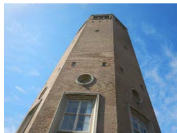
Foto 20 In geschat wordt dat circa 15% van de bakstenen aan het oppervlak is beschadigd.
