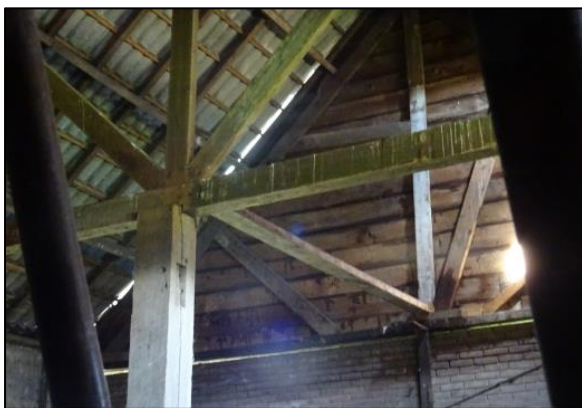
Figuur 11. Foto van balken in Neelstraat 3. Zichtbaar zijn strepen van poepsporen.
