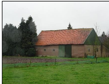
Figuur 8. Vervallen schuur met verzakt dak en ontbrekende dakpannen.
